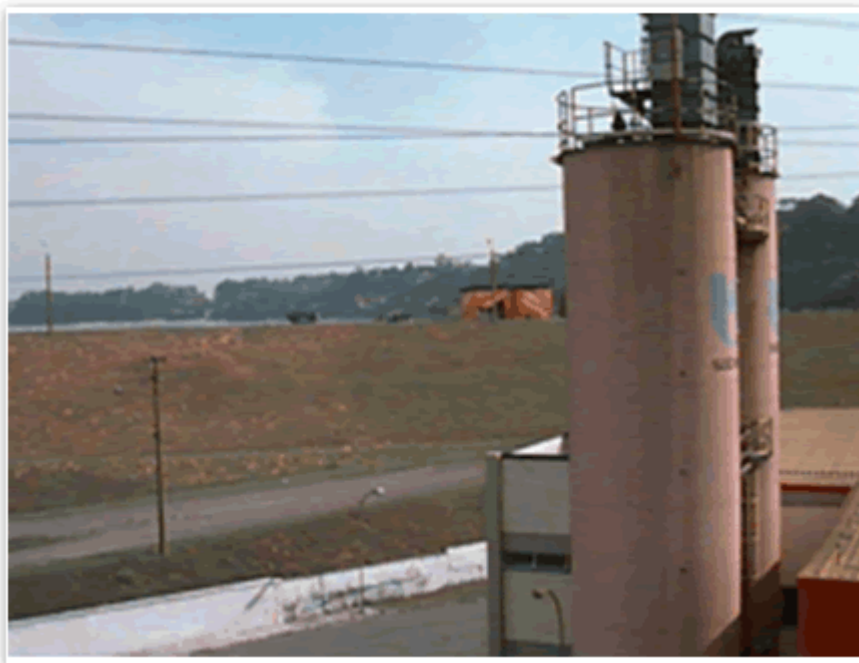
Figura 5 – Silo de armazenagem de Carvão Ativado em Pó (CAP), na EEAB
