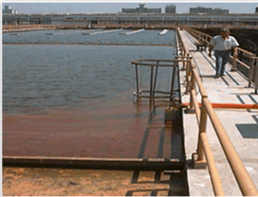
Figura 10 – Decantador: floculação (inferior), decantação (centro) e calhas de captação para os filtros (superior)
