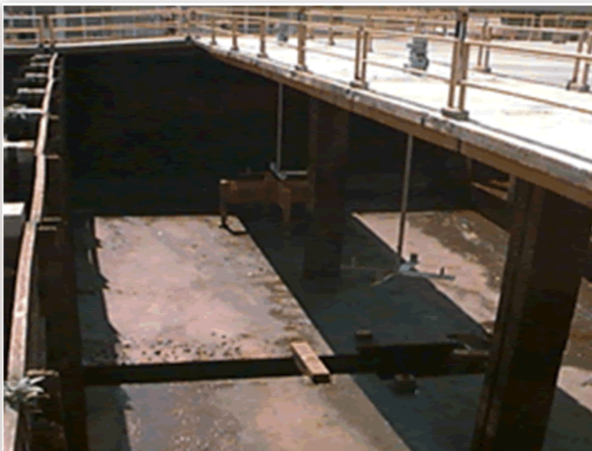
Figura 9 – Decantador: parede separadora vazada (esquerda) e floculadores (direita)
